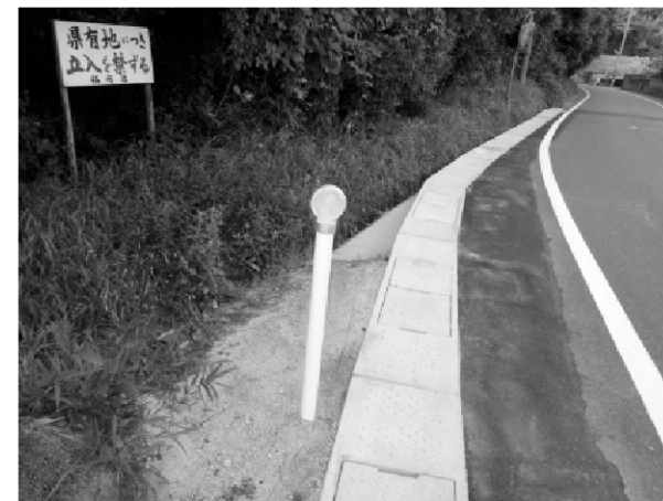
▲新設された反射ポール
