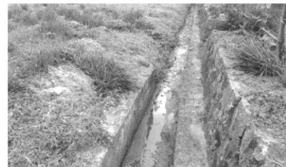
土砂が入り込む側溝(平成25年12月)
